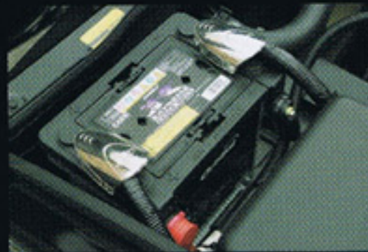
バッテリーは全部で4つ。場所が場所だけに設置に苦労したのがリヤホール間のバッテリーだ。
